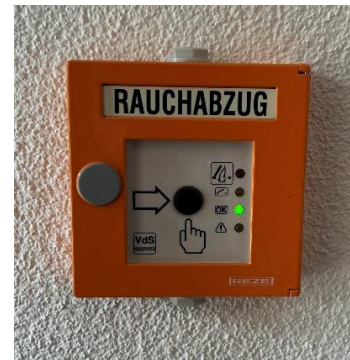
Bild 3 Rauch- und Wärmeabzug
